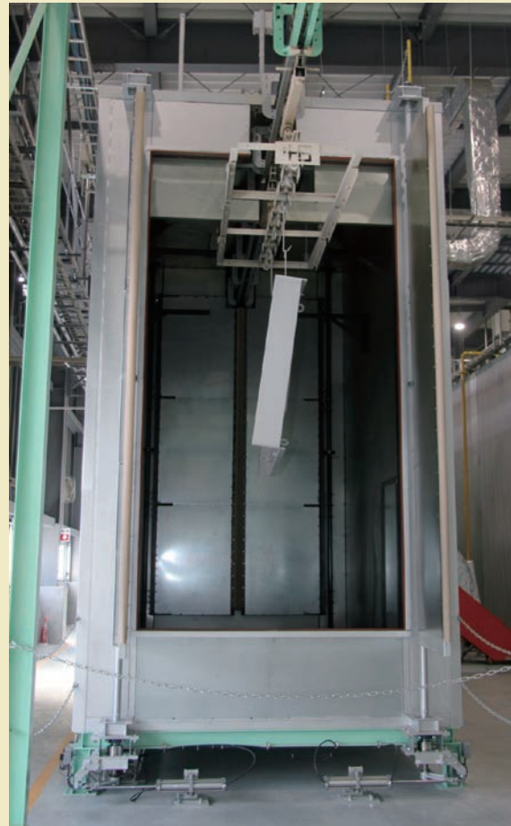
溶剤塗装焼き付け乾燥炉出口
