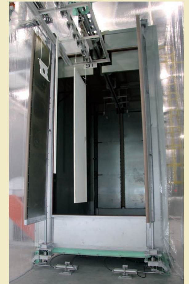
粉体塗装焼き付け乾燥炉入口(二重扉で熱効率を上げる)
