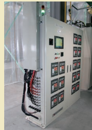
粉体塗装自動ガン制御盤
